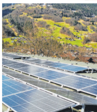
Der Ausbau von PV-Anlagen soll vorangetrieben werden.
